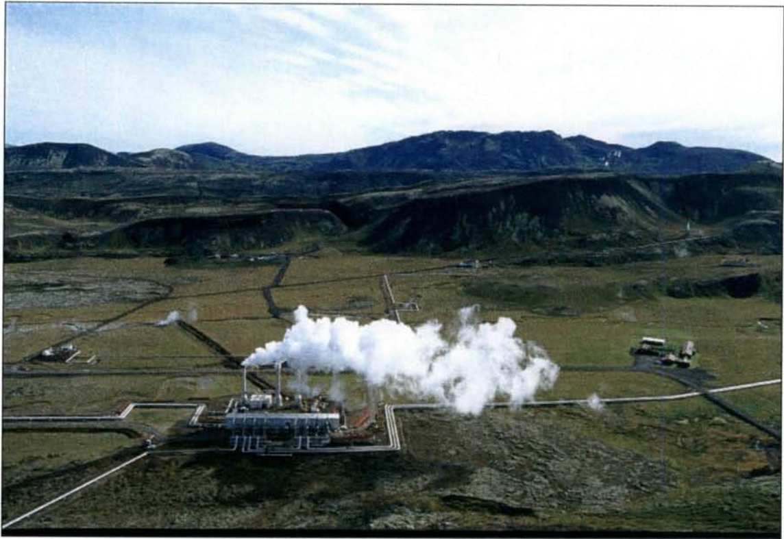
24. ljósmynd. Skiljustöð Nesjavallavirkjunar.
